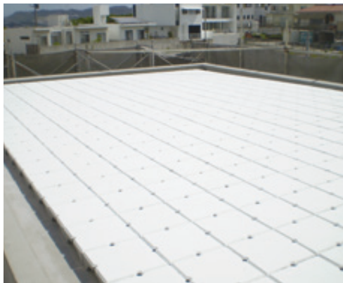
⑧ 屋根スラブに風を通す遮熱ブロック
